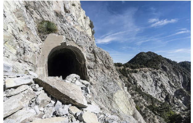
Einsturzgefährdeter Tunnel nach Erdbeben.
